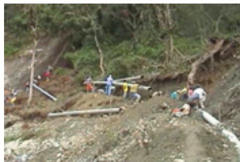
Figura 4.3. Daños en el sistema de conducción de la quebrada Curitroje año 2005
