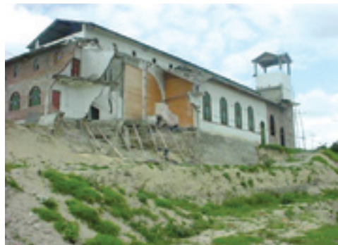
Figura 4.2. Daños a la infraestructura
