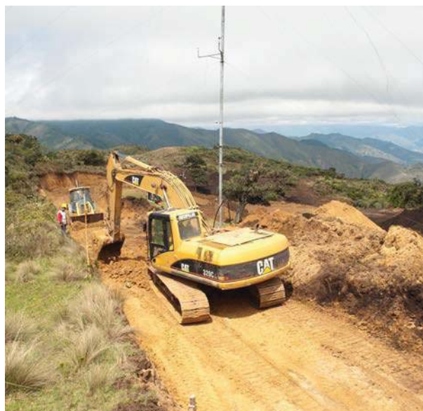
El proyecto eólico Villonaco está en construcción, entrará en funcionamiento a finales del 2012
